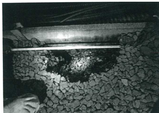
図-6 棒状補強材施工時の道床陥没
