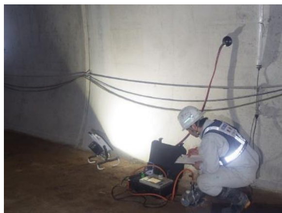
写真-2 透気試験実施状況
