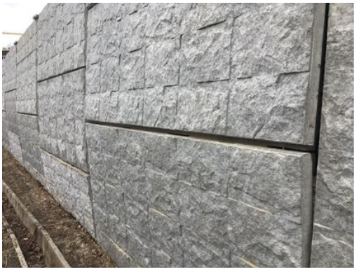
図 2 補強土壁の変状事例
