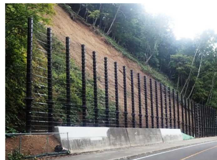
写真-1 土砂堆積用支柱フェンス
