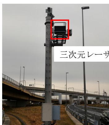
写真-1 センサー設置状況
