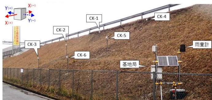
写真-2 センサー設置状況
