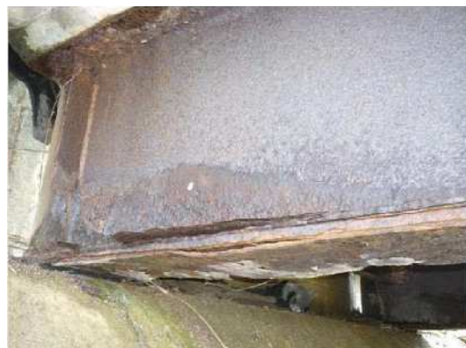
写真-3 C橋の劣化・損傷状況 (460m)
