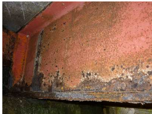
写真-4 D橋の劣化・損傷状況 (720m)
