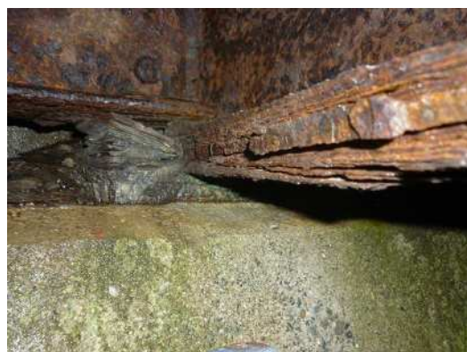
写真-2 B橋の劣化・損傷状況 (350m)
