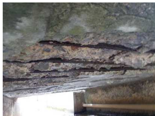
写真-1 A橋の劣化・損傷状況 (110m)
