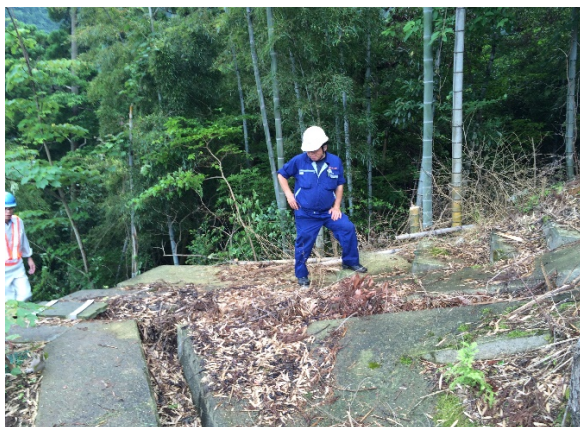
写真1 枯葉による排水路の閉塞状況
