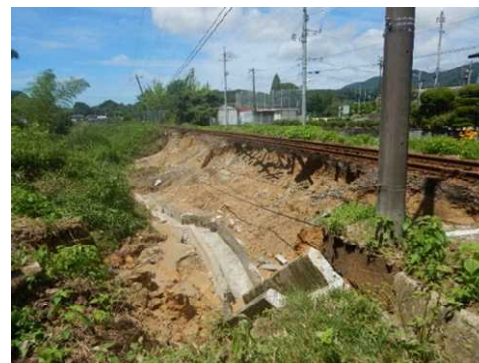
図 4 盛土の崩壊状況(調査箇所 D)
