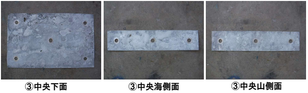
図-9 亜鉛消耗状態
