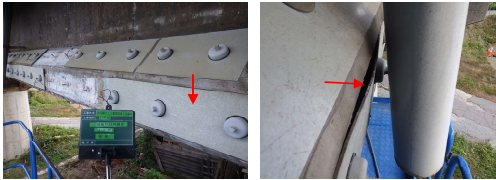
図-6 ガラス繊維露出・板膨れ
