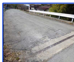
(2) 床版上面土砂化
