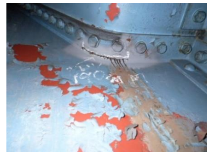
図1 き裂発生状況
