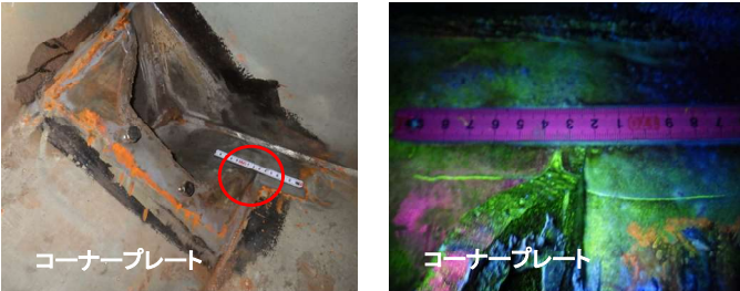
図-1 切り欠き部の亀裂損傷
