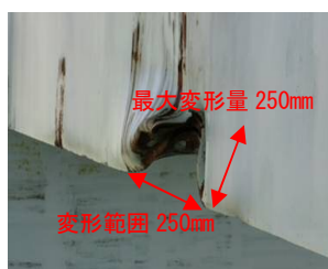
写真-2 海 P-74 の梁下フランジの面外変形
