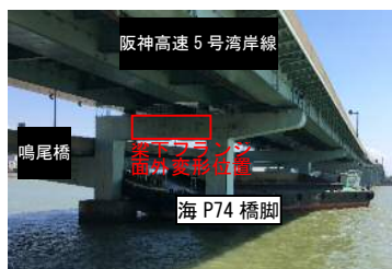
写真-1 船舶衝突状況
