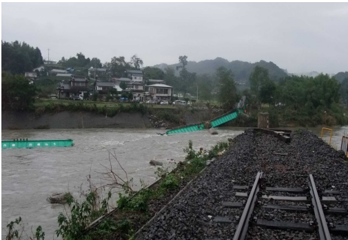
写真 1 流出状況（起点側橋台より）
