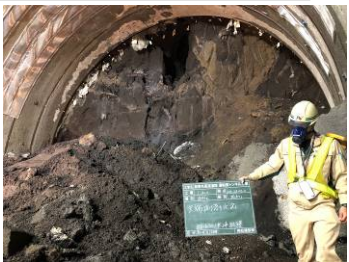
写真－３ 切羽崩落状況
