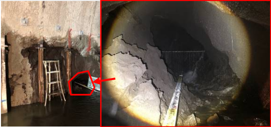
写真－１ 坑内水平水抜きボーリングによる側壁崩落状況
