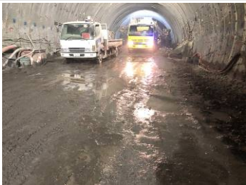
写真－２ 路盤泥濘化状況
