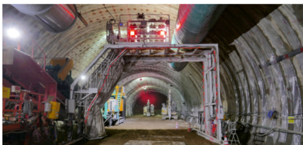
写真-5 警告照明システム
