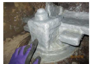
写真-8 支承部モニタリング
