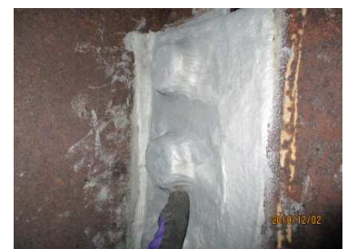
写真-9 添接部モニタリング
