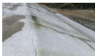
写真-2 開口クラック
