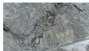
写真-3 地山崩壊
