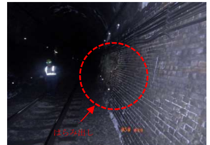
写真-1 変状写真
