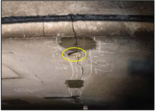
写真-1 検査孔とひび割れ
