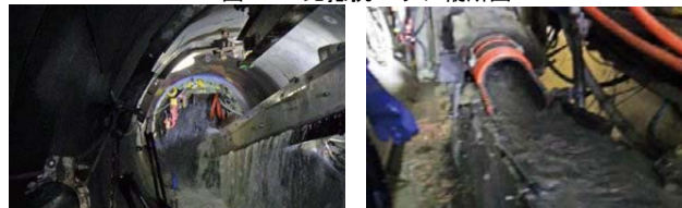
図-4 泥土圧式シールド施工時の湧水状況
