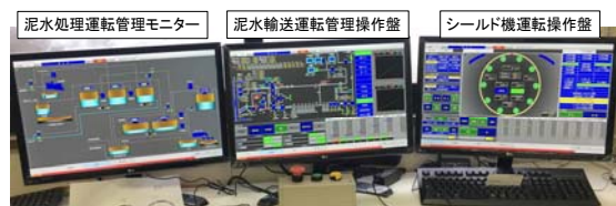
図-8 中央管理室における掘進管理システム
