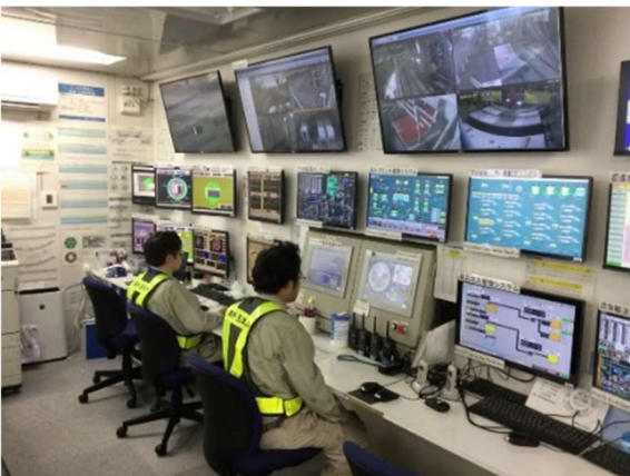
写真-4 中央制御室モニター監視状況
