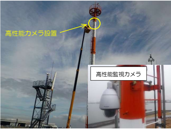
写真-1 高性能カメラ設置状況
