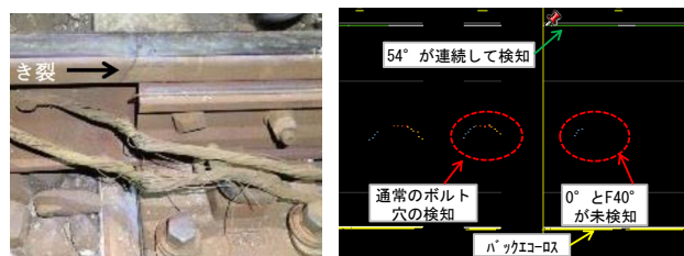
図-3 レール頭部横裂のレール写真と探傷車探傷画像
