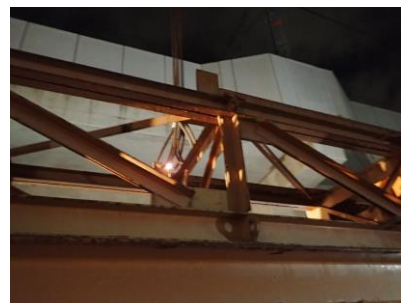
写真-3 火花発生状況
