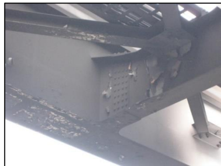
写真-1.2 横桁塗膜の燃焼
