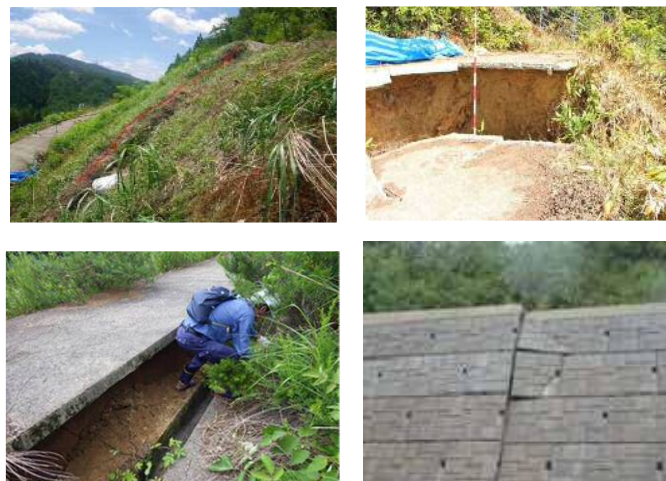
●写真 2 被災状況
