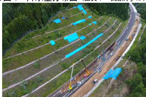
●写真 1 被災直後の状況（高山市上小鳥地区）
