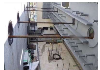
写真-1 仮落橋防止部材
