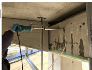
図4 補修対象箇所穿孔状況
