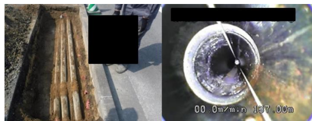
図2 PL-PS管の被災箇所
