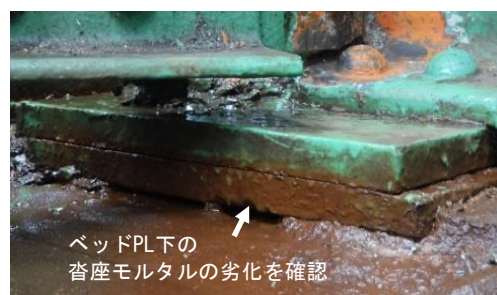
図4 沓座モルタルの劣化
