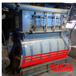
写真-2 ミキサ加温設備
