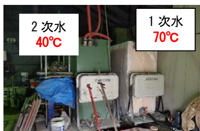
写真-1 練混ぜ水加温設備
