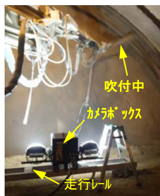
写真-1 カメラ配置（走行レール）
