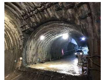
図-4 交点接続状況
