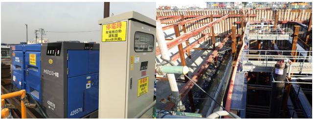
図 7 電源自動切換装置（左），バイパス配管（右）
