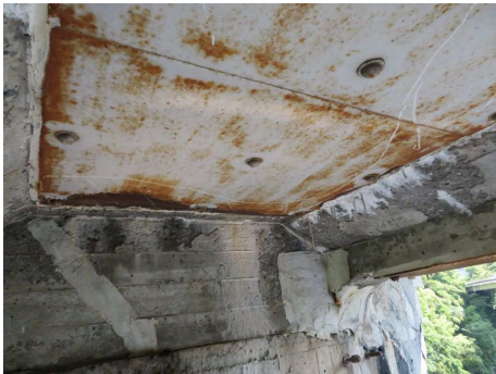
図-2 補強鋼板の腐食と遊離石灰
