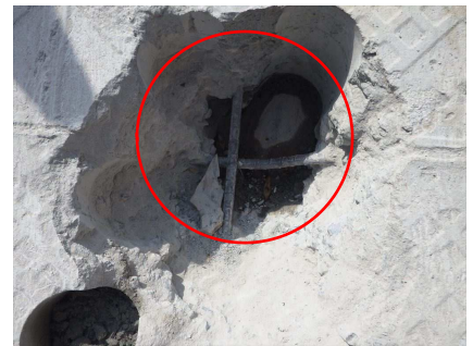
図-4 床版の滞水調査
