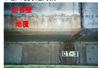
写真-2 防音壁と地覆の縁切れ
