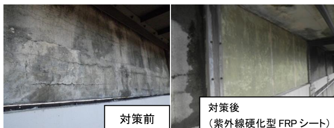
写真-1 嵩上げ PC 板の変状と対策
