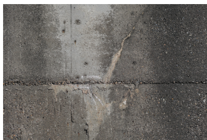
写真-4 微細なひびわれ検出
