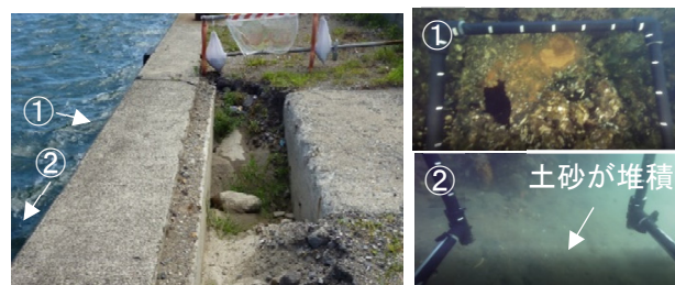
図-5 陥没直下の鋼矢板及び海底地盤の状況
