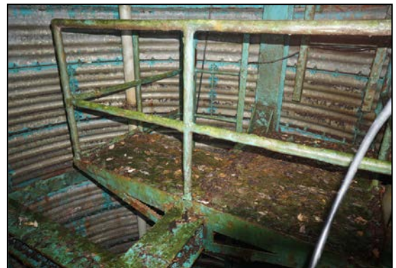
写真-5 点検検査設備腐食状況
