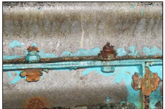
写真-4 変状状況 腐食
