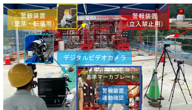
図-4 画像認識・解析安全管理システム試行状況
