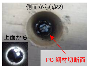
写真-6 切断後の PC 鋼材
