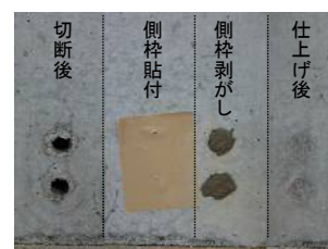
写真-9 地覆側面の状態
