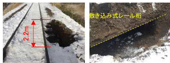
図-2 陥没発生状況
