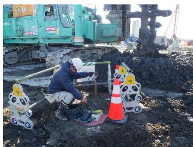
写真-3 地中変位測定状況
