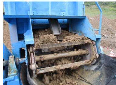
写真-3 CSG材料供給設備
