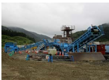
写真-1 CSG混合設備全景
