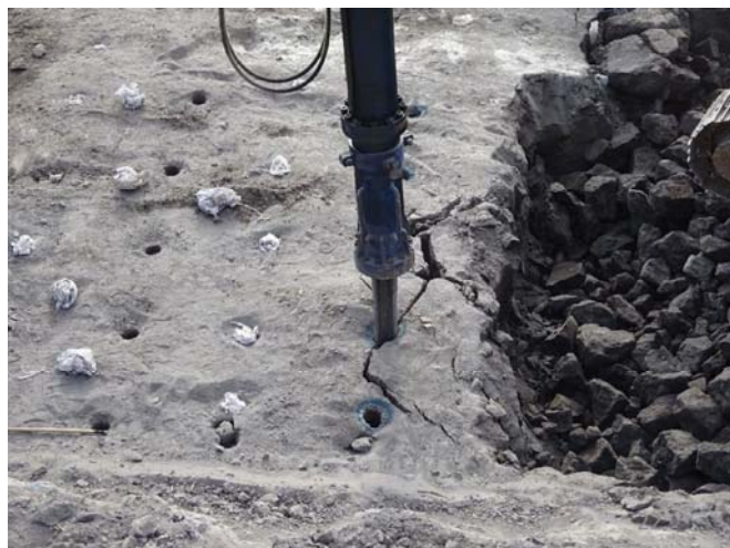
写真-3 クラック発生状況
