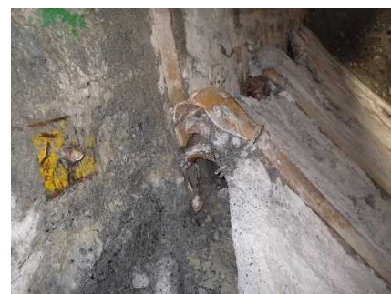
写真-1 インバートストラット変状状況
