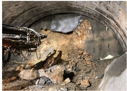
写真-2 強風化頁岩の崩落 (TD310m)
