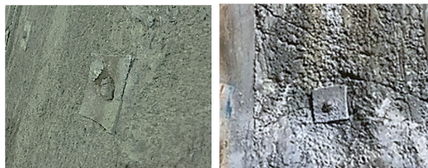
写真-3 ロックボルト、吹付コンクリートの変状
