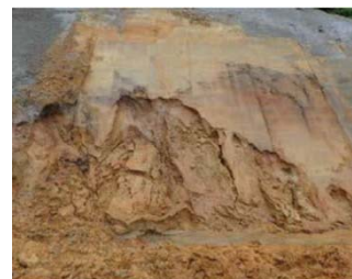
図-3 右側法面崩壊状
