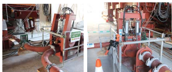
写真-2 配管系統の高速切替え装置
