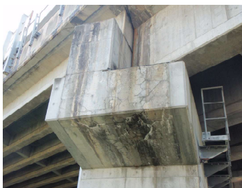
図-2 ASR劣化したコンクリート構造物（補修済）
